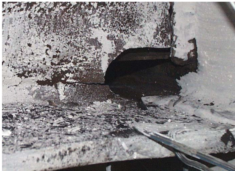
(d) Fracture in link web surrounding bottom weld access hole (0.04-2N)
